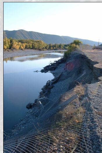
Exemple d'érosion de berge
